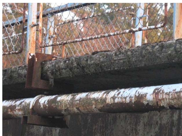
Fot. 4 Uszkodzona krawędź pomostu od strony dolnej wody (ok. 6,5 m) – beton odpadł, pozostawiając nieosłonięte pręty zbrojeniowe.
